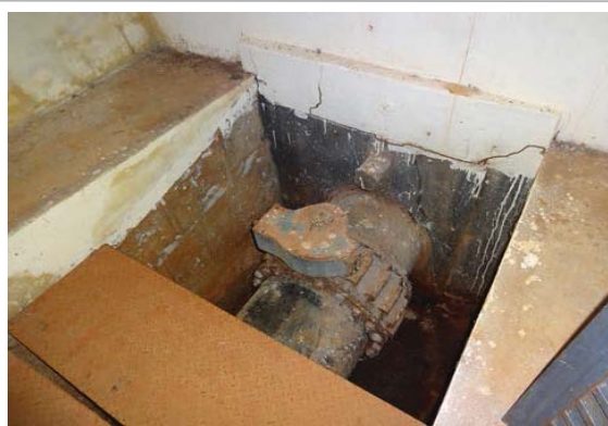
Foto 02: Tomada d'água - registro borboleta.
