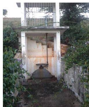
Foto 02: Torre de comando - registro gaveta.
