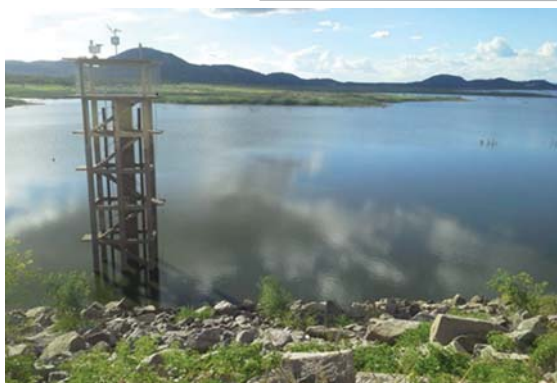
Foto 01: Torre de comando com plataforma PCD.
