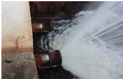
Foto 02: Liberação para jusante - válvulas dispersoras.
