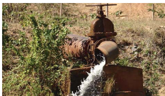
Foto 02: Tomada d'água - registro gaveta.
