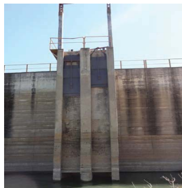
Foto 02: Tomada d'água - controle das comportas.
