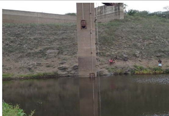
Foto 02: Comportas na torre de comando.
