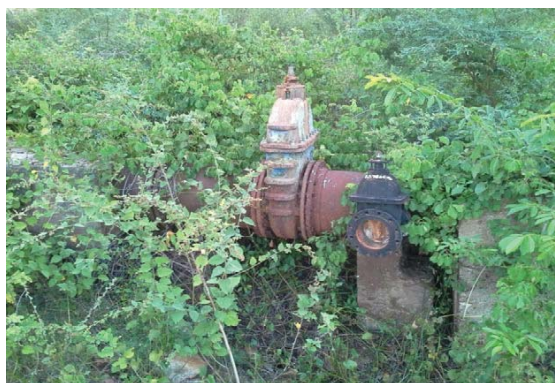
Foto 02: Registros da tomada d'água da ETA (COMPESA).
