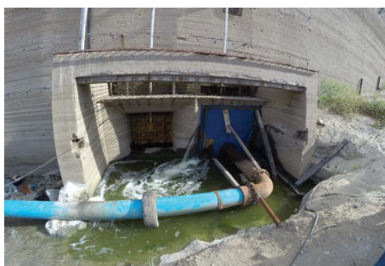
Foto 02: Tomada d'água - comporta e captação para abastecimento.
