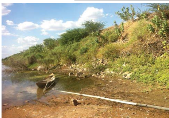
Foto 01: Paramento de montante - presença de cobertura vegetal.
