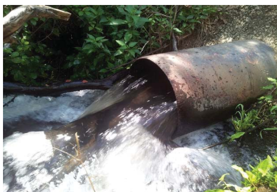
Foto 02: Tubulação de liberação para jusante.
