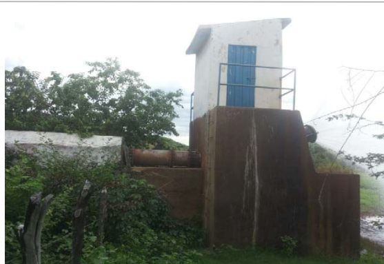
Foto 02: Tomada d'água - válvula dispersora.
