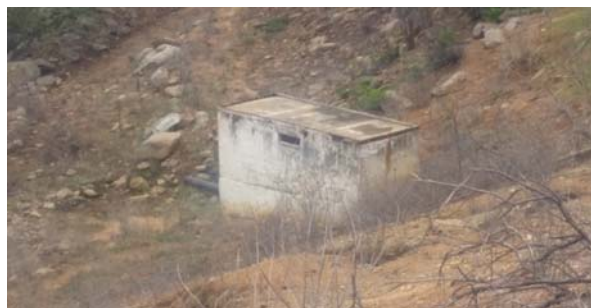
Foto 02: Tubulação de liberação para jusante.
