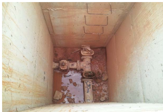
Foto 02: Registros de controle da tomada d'água do reservatório.
