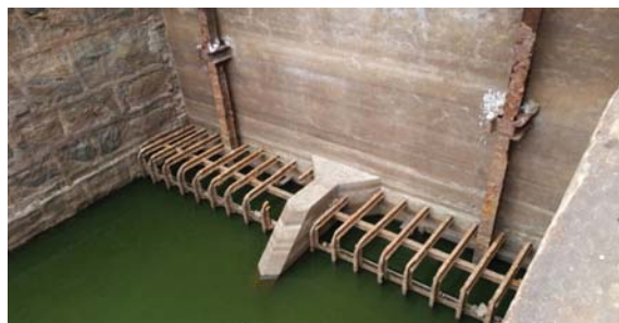
Foto 02: Grades instaladas Nas comportas da tomada d'água.
