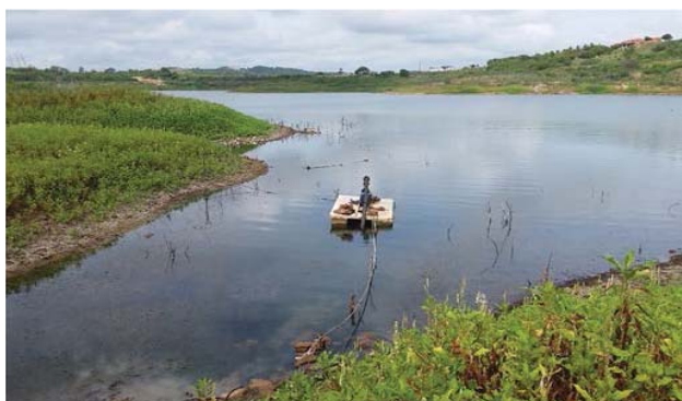
Foto 02: Bombas sobre flutuantes - abastecimento humano.
