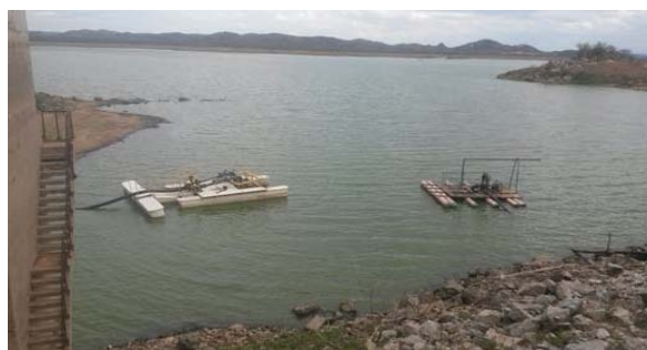
Foto 02: Bombas sobre flutuantes - abastecimento humano.
