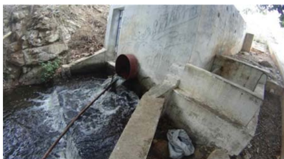
Foto 02: Tubulação de liberação para jusante.
