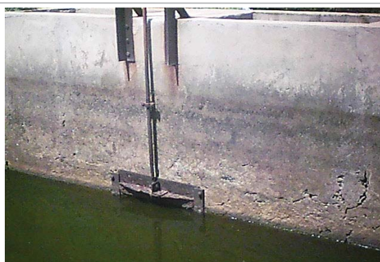
Foto 02: Comporta de controle da tomada d'água.
