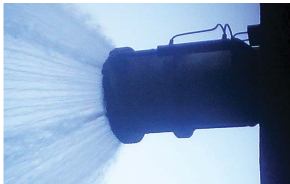
Foto 02: Detalhe da válvula dispersora.
