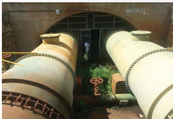
Foto 02: Tomada d'água - tubulações e controle.
