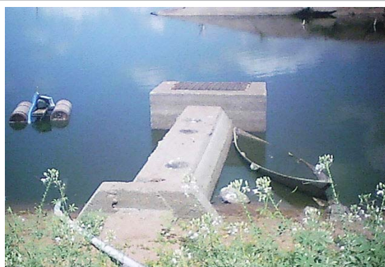
Foto 02: Tomada d'água e captação com flutuantes provisória.
