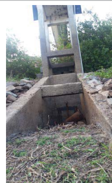
Foto 02: Detalhe da comporta da tomada d'água.
