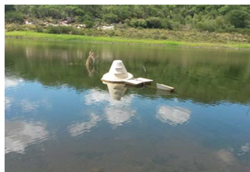
Foto 02: Bombas sobre flutuantes abastecimento humano.
