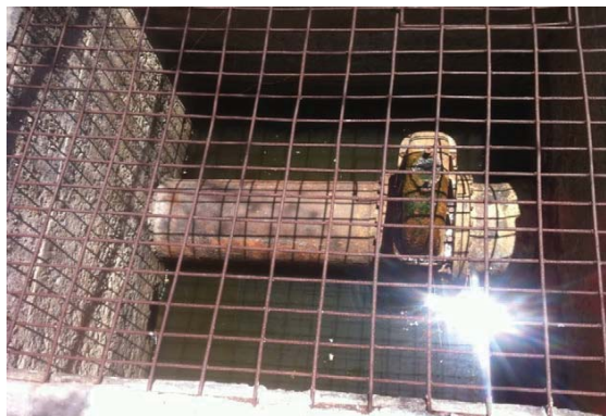
Foto 02: Tomada d'água - registro gaveta.
