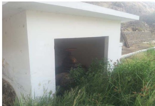
Foto 02: Válvula da tomada d'água.
