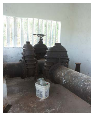
Foto 02: Conjunto de registro gaveta.
