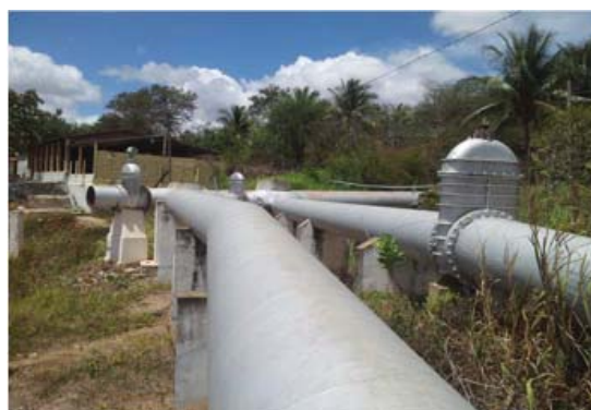
Foto 02: Tomada d'água - Captações CAGEPA.
