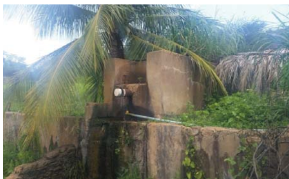
Foto 02: Estrutura de liberação para jusante.
