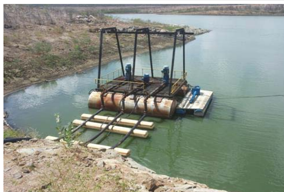
Foto 02: Bombas sobre flutuantes - captação Itatuba.
