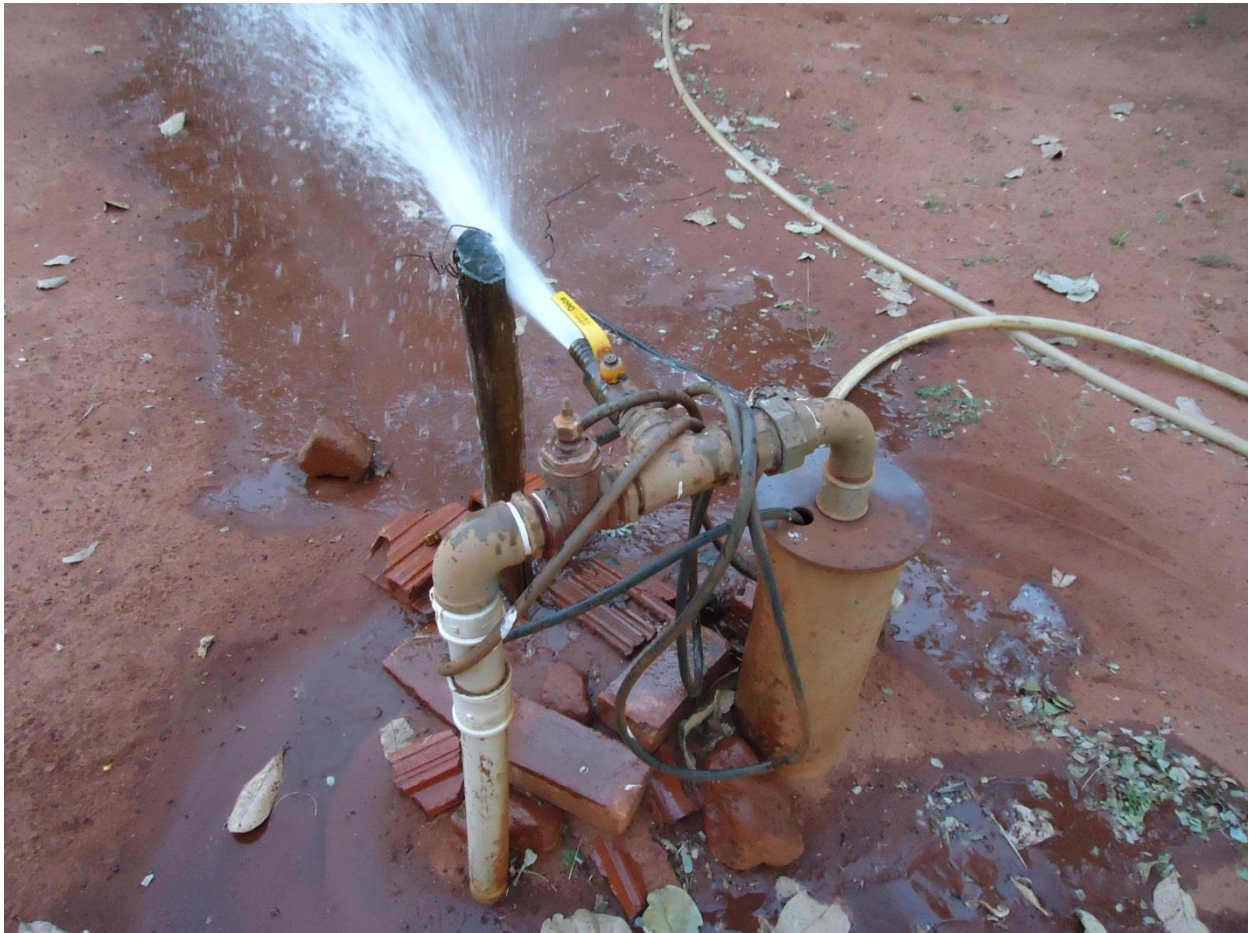
Figura 4.56 – Exemplo de poço cadastrado sem proteção sanitária (laje de proteção e cimentação do espaço anular).
