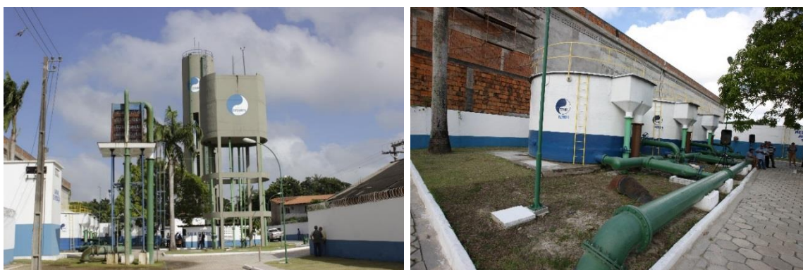
Figura 12 – Sistema Isolado Sideral (Belém), composto por três poços profundos. Fonte: COSANPA.
