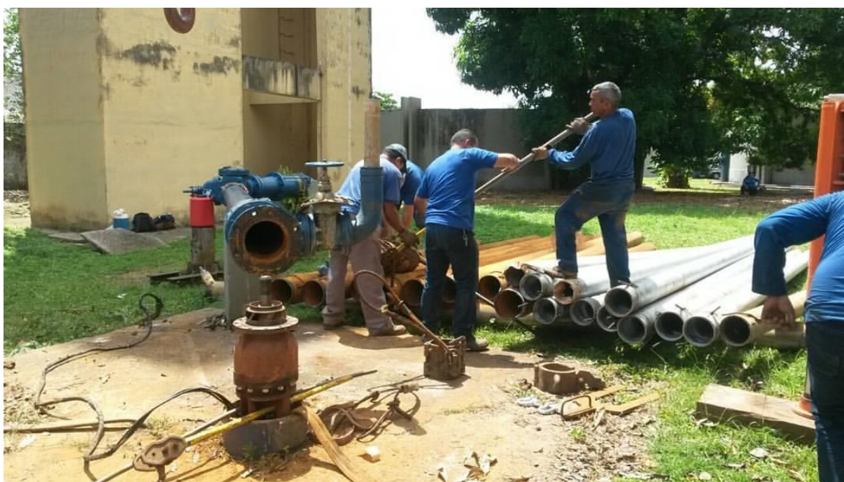
Figura 14 – Sistema Isolado Sabiá, em Ananindeua, composto por dois poços profundos. Fonte: COSANPA.
