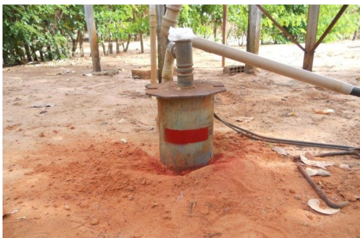
PO-02 Granja Confiança - poço existente utilizado como poço de observação
