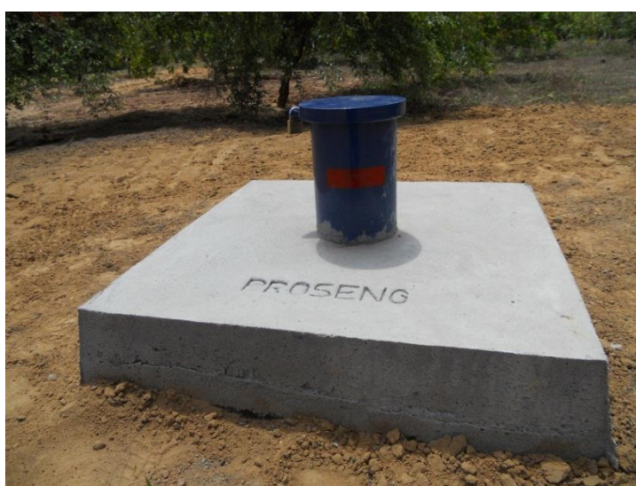
PE Ceará-Mirim – acabamento construtivo e marca da ranhura do nivelamento topográfico
