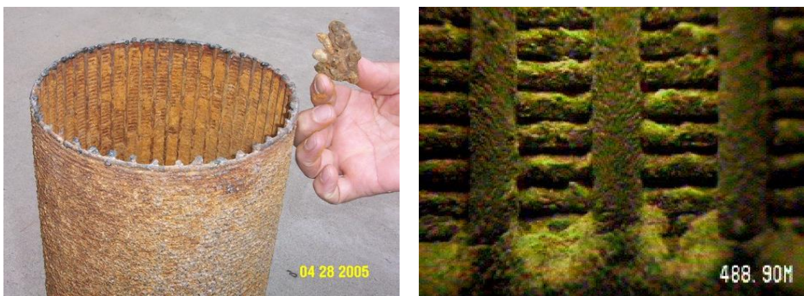
Figura 18 – Colmatção e incrustação de filtros.
